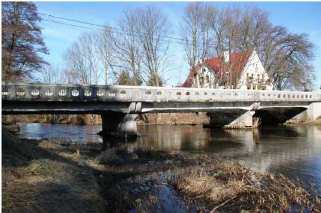
Widok zanieczyszczeń koryta rzeki w obrębie lewego przyczółka powodujący zakłócenia przepływu, Erozję i karbonatyzację lewego przyczółka i filara nr 2.
