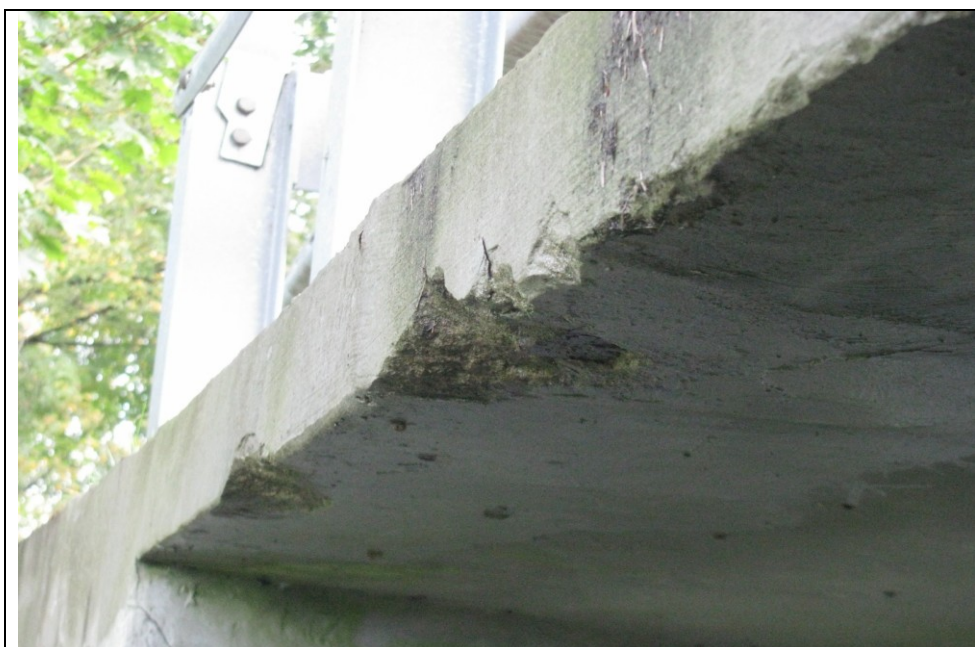
Fot. 6. Ubytki betonu w obrębie krawędzi wspornika konstrukcji przęsła.
