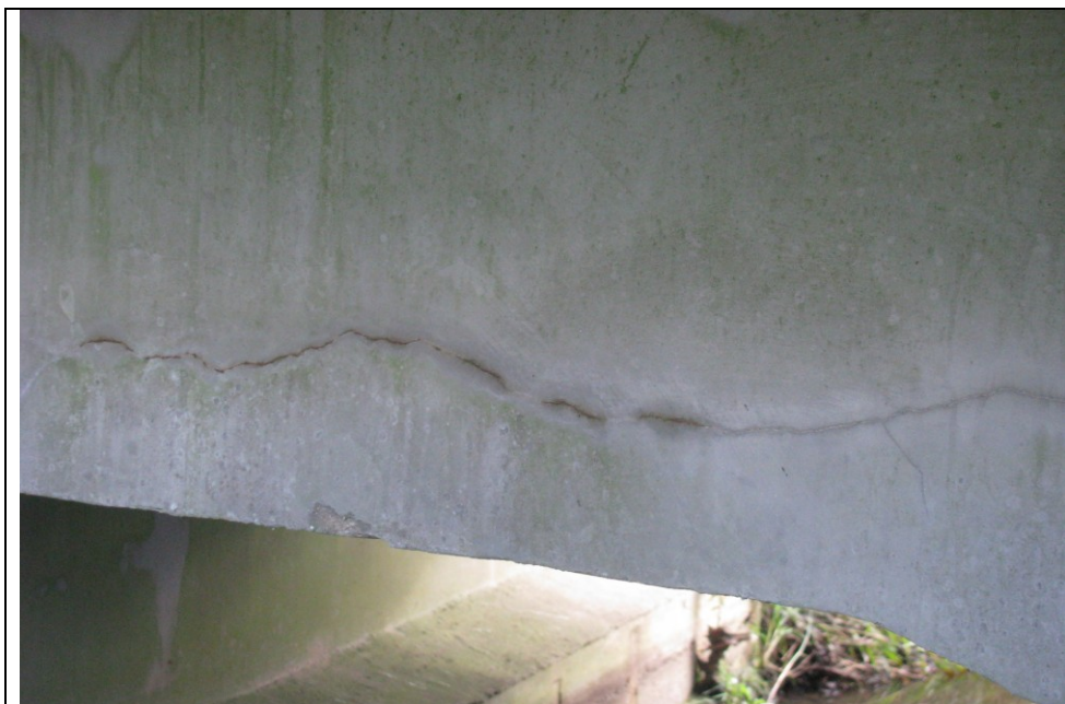
Fot. 5. Poziome spękanie betonu na długości konstrukcji przęsła.
