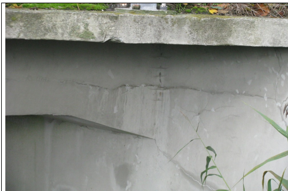
Fot. 4. Poziome spękanie betonu ścianki żwirowej przyczółka i konstrukcji przęsła w obrębie skosu przy podporze.
