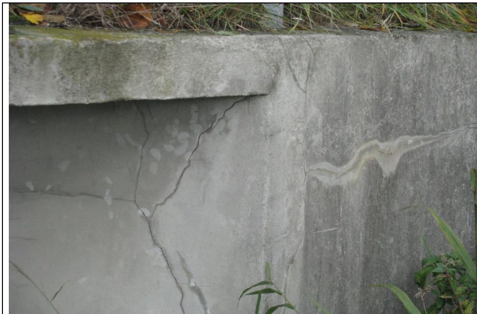
Fot. 3. Rozległe spękania betonu ścianki żwirowej i skrzydła przyczółka.
